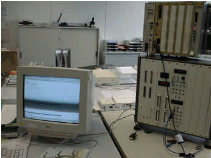
Abb. 19: Speicherprogrammierbare Steuerung „Siemens S5“
